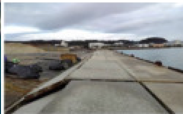
岸壁(-4.5m) ・エプロン背後沈下
